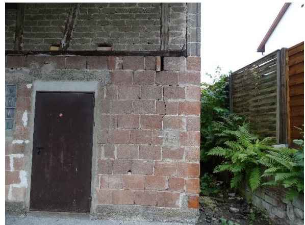
Abb. 6: Einflugöffnungen in Form von Spalten und zugängliche Hohlblocksteine im Bereich von Schadstellen an der Scheune
