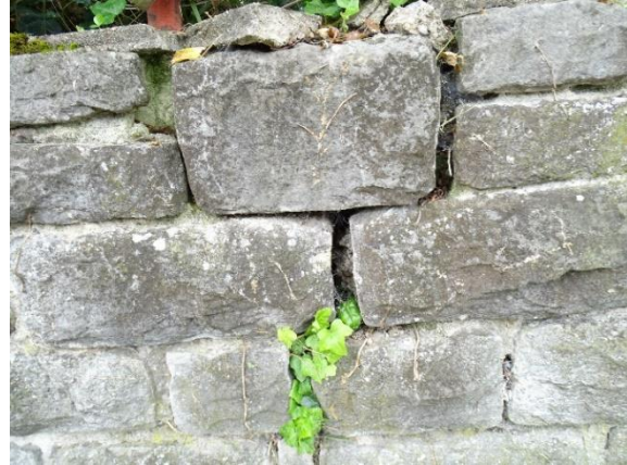
Abb. 21: Einzelne Spalten in Mauersockel
