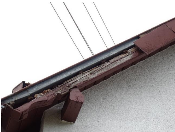
Abb. 13: Vermorschtes Holz am Dachgebälk
