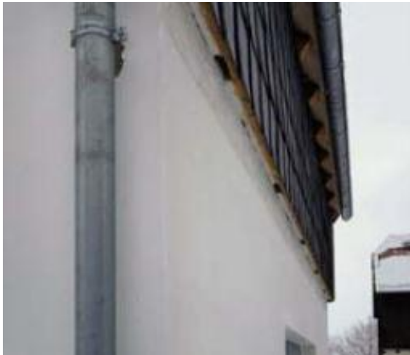
Abb. 24: Spaltenquartiere hinter Schieferverkleidung 2
