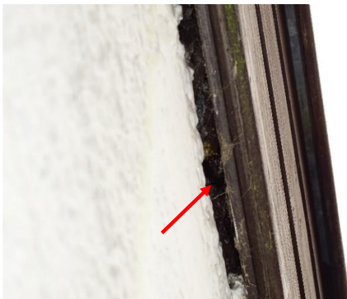
Abb. 18: Spalte zwischen Putz und Holzverkleidung (Garagengebäude)
