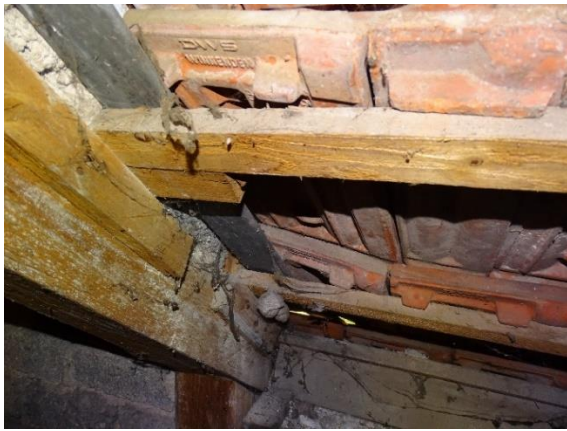
Abb. 7: Lücken zwischen den Dachziegeln im Dachstuhl
