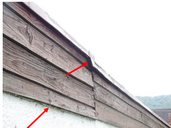
Abb. 14: Spalten zwischen Mauer, Holzverkleidung und Attikaverwahrung
