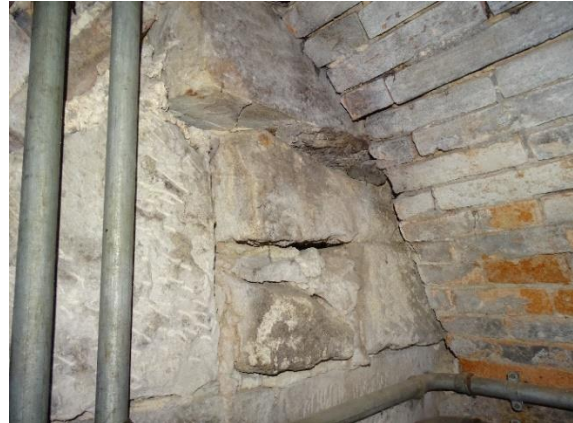
Abb. 12: Mauerspalten im Gewölbekeller
