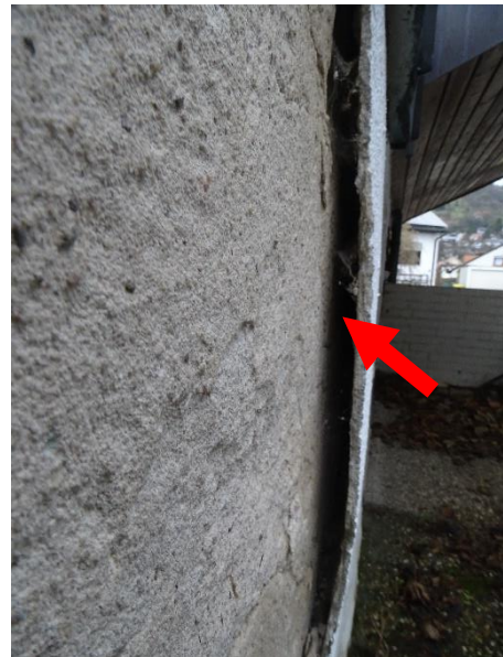
Abb. 13: Abgeplatzter Putz an der Garagenwand mit dahinterliegendem Hohlraum (roter Pfeil)
