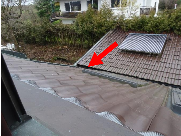
Abb. 10: Mögliche Öffnung zu einem Hohlraum unter den Dachziegeln der Garage (roter Pfeil)
