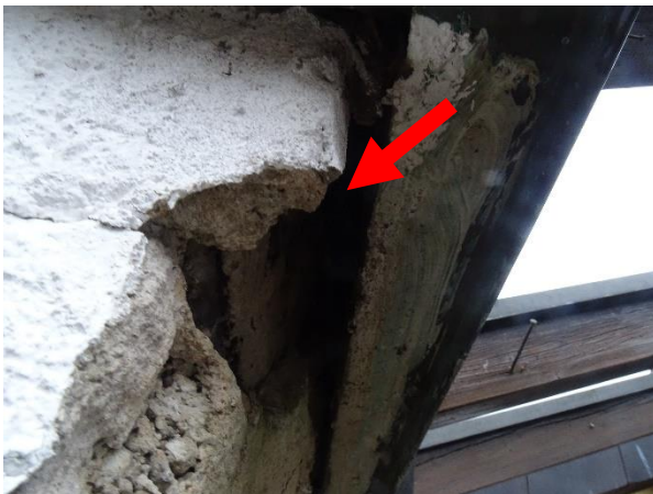
Abb. 12: Öffnung an der Metallattika und dem Dach der Garage (roter Pfeil)
