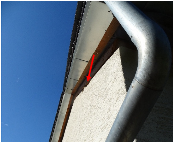
Abb. 5: Spalte unterhalb des östlichen Ortgangs am Dachsparren (roter Pfeil), Stand 08.08.2025
