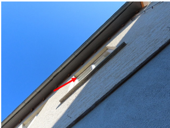
Abb. 7: Spalt zwischen Fenster und Wand auf der Südseite des EFHs (roter Pfeil)
