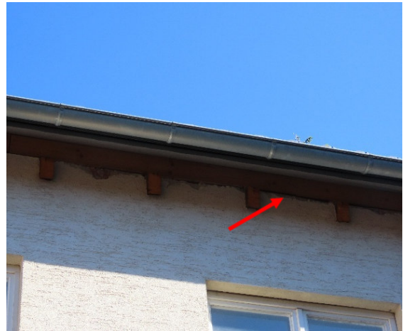
Abb. 6: Fuge im Traufbereich auf der Südseite des EFHs (roter Pfeil)
