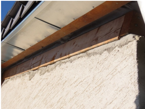
Abb. 10: Verfugter Dachsparren an der Ostgiebelwand, Stand: 28.08.2025
