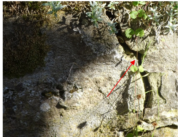
Abb. 14: Spalt im östlichen Teilbereich des Mauersockels (roter Pfeil)
