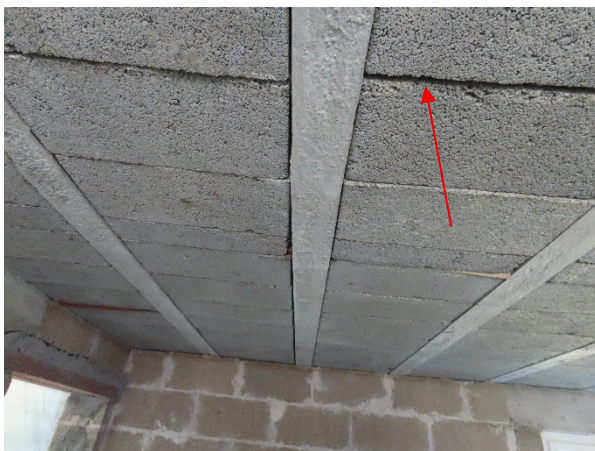
Abb. 12: Decke im Erdgeschoss (Norden) mit flachen Spalten (roter Pfeil)
