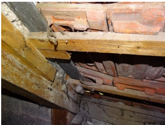
Abb. 7: Lücken zwischen den Dachziegeln im Dachstuhl
