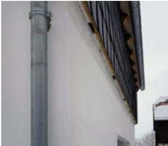
Abb. 24: Spaltenquartiere hinter Schieferverkleidung 2
