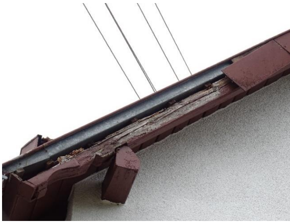
Abb. 13: Vermorschtes Holz am Dachgebälk
