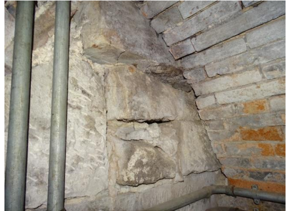
Abb. 12: Mauerspalten im Gewölbekeller
