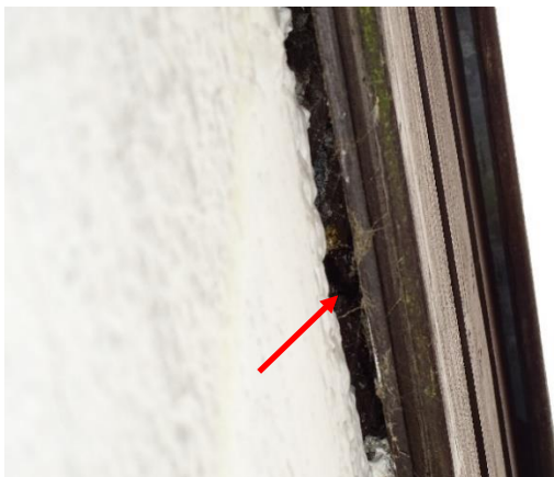
Abb. 18: Spalte zwischen Putz und Holzverkleidung (Garagengebäude)
