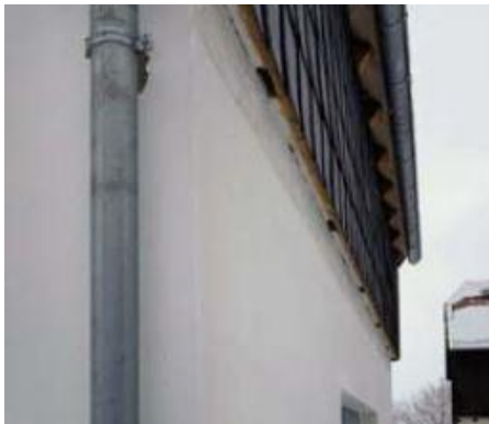
Abb. 8: Spaltenquartiere hinter Schieferverkleidung 7
