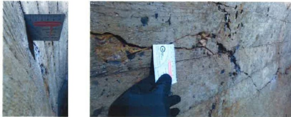
Abb. 10 bis 12: Rissverlauf zulaufseitig (Breite: bis 10 mm, Tiefe: bis 12 mm)
